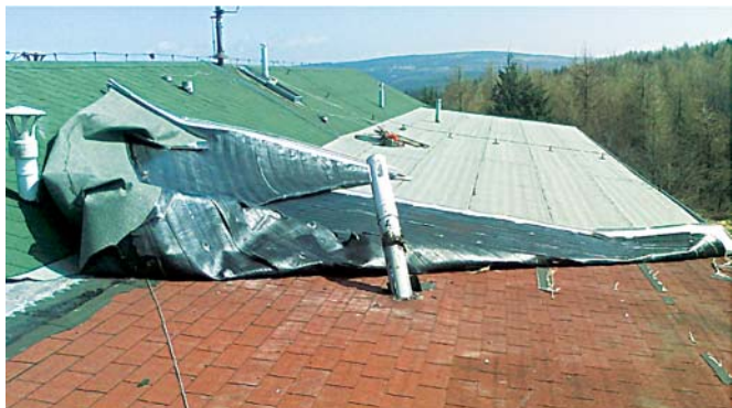
Shrnutá střecha po vichřici na obecním domě
